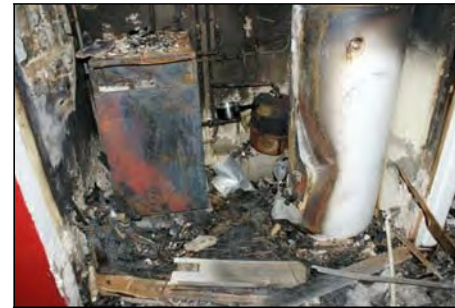
Ballon d'eau chaude
