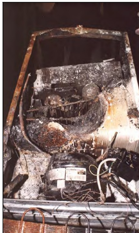
Surchauffe de la cloche d'un réfrigérateur
