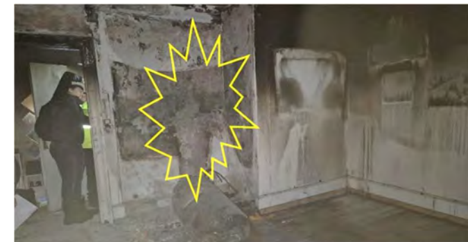
Impact thermique à l'emplacement du ballon d'eau chaude électrique
