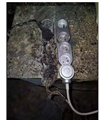
Comparaison avec une multiprise identique intacte.
