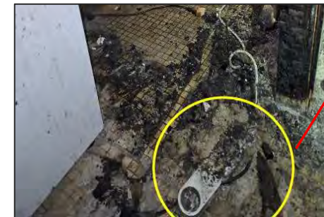
Départ de feu au niveau d'un interrupteur de multiprise
