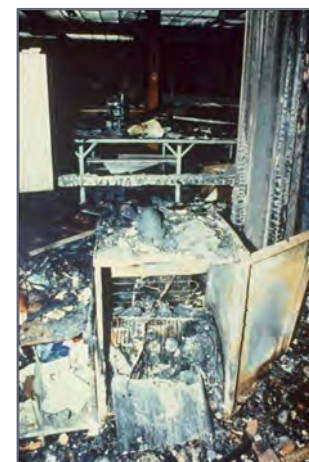
Départ de feu au niveau d'un réfrigérateur dont la porte a été laissée ouverte (surrégime).
