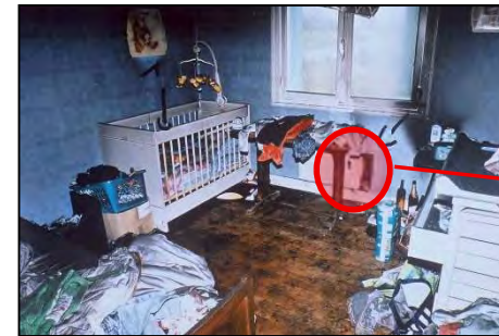
Départ de feu au niveau d'un boîtier de commande de convecteur
